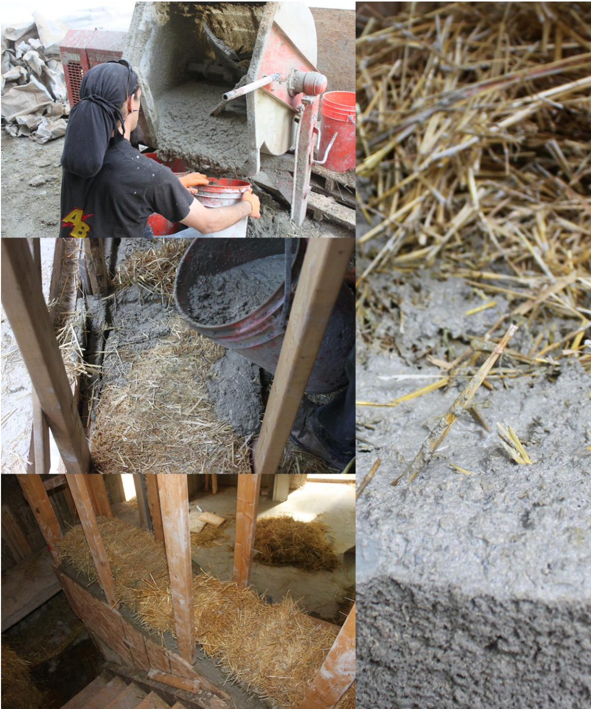
Figure 3.2 : Mur construit selon la technique GREB (Photos : Sébastien Bergeron lors de la construction de sa maison à Rawdon en août 2013)
